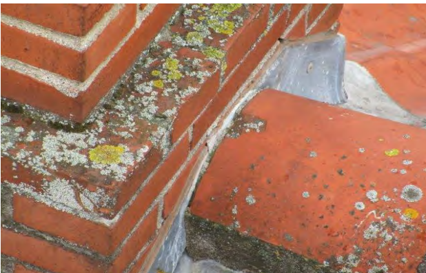
Begyndende fugeslip ved inddækninger
