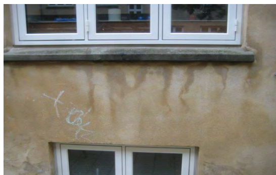
Misfarvninger under sålbænke
