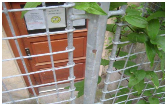
Rustgennemslag på værn
