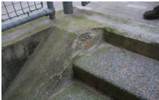
Skade på tcykelrampe
