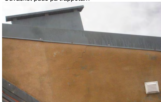
Revne i murværk på trappetårn
