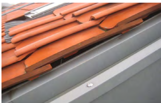
Manglende tætning af tagsten mod zinkflunker
