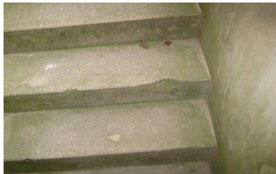
Skade på trappetrin
