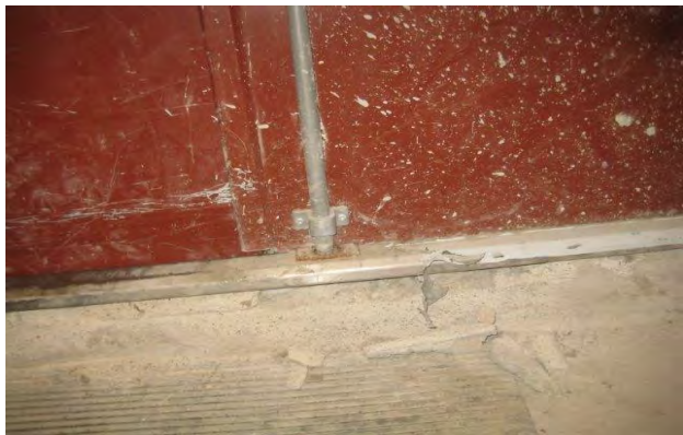
Defekt mørtelfuge under dør til varmecentral
