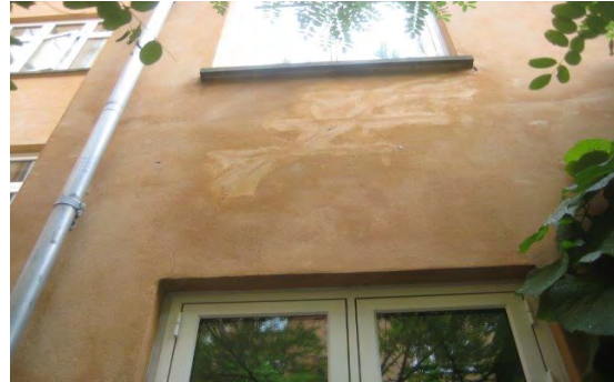
Revner i puds ml. vinduer
