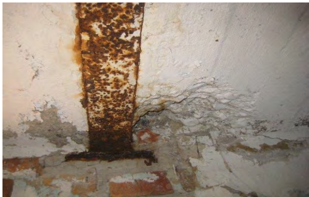
Rustne jern ved kappedæk i kælder
