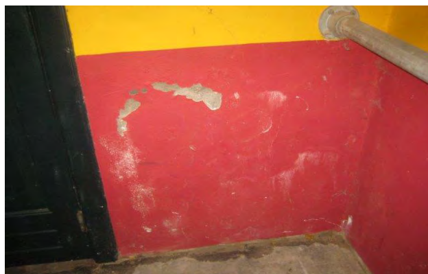
Afskalninger på murværk
