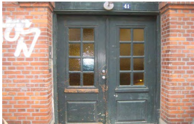
Gadedøre med nedslidt malerbehandling
