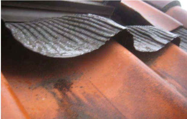
Blyerstatning ligger ikke tæt til tagsten
