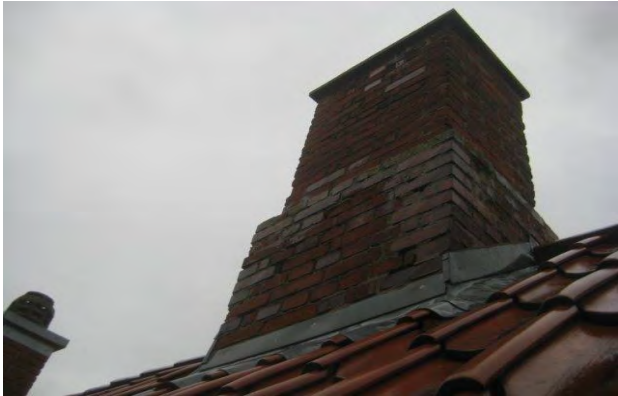
Skorsten med udvaskede fuger
