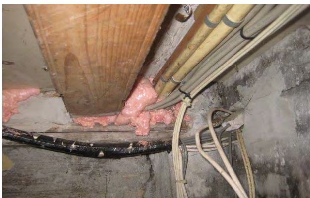
Ulovlig brandtætning mellem kælderrum
