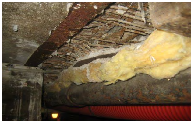
Defekt pudset loft
