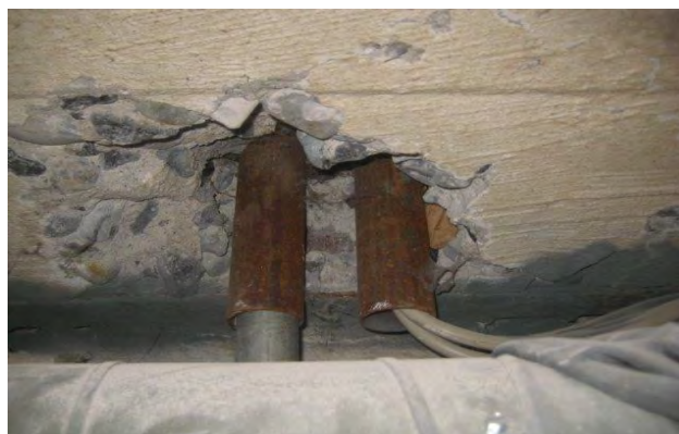
Manglende brandtætning ved gennembrydninger
