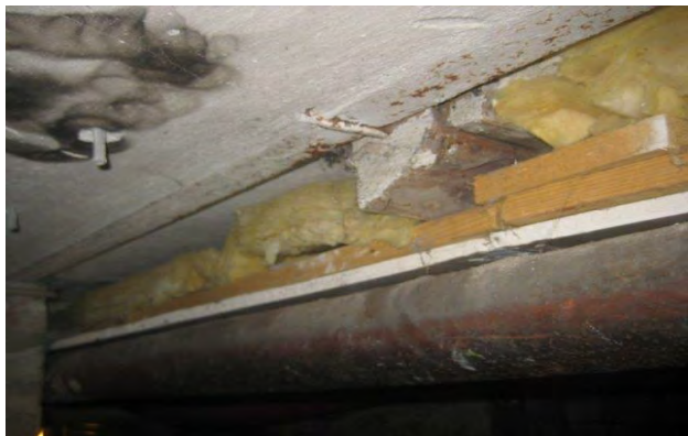
Manglende kantafslutninger ved gipslofter
