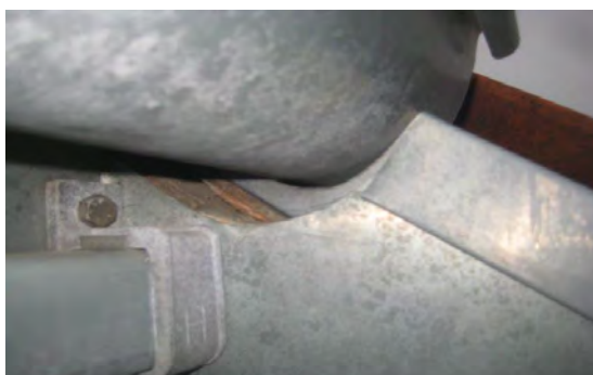
Mangelfuld inddækning under tagrende (blotlagt træ)
