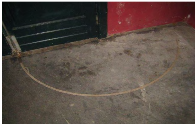
Slid på belægning grundet defekt skudrigel
