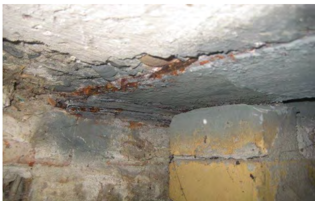
Ny overfladerust på rustbehandlet jerndrager
