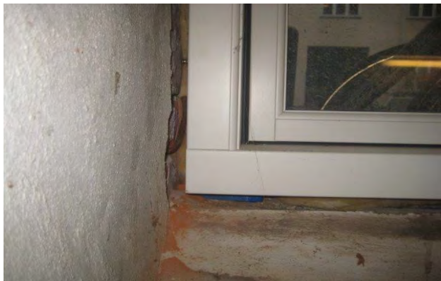
Manglende fuge indvendig i kælder
