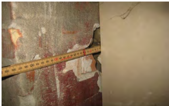
Manglende brandlukning ved tagbolig mod loftrum
