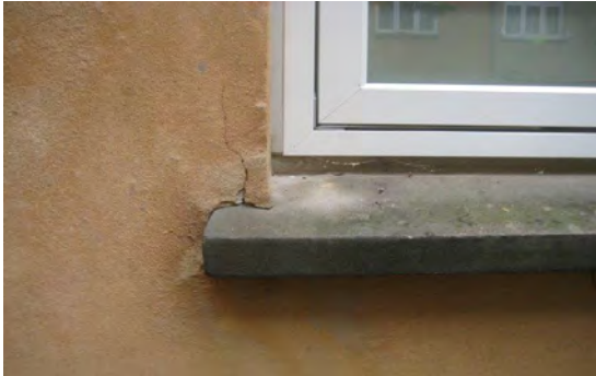
Revnedannelser ved sålbænke
