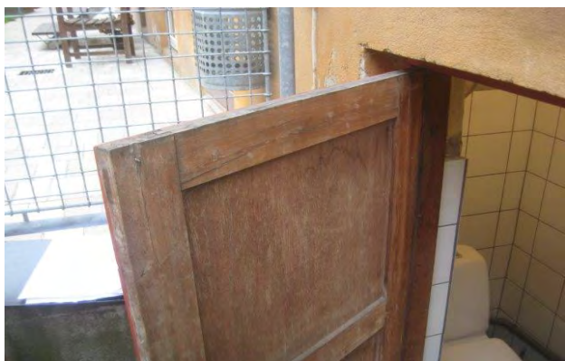
Nedslidt malerbehandling på dør til gårdtoilet
