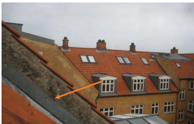
Begyndende fugeslip ved elastisk fuge
