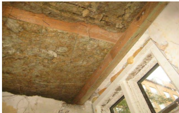
Manglende loftbeklædning i kælder under AV 58
