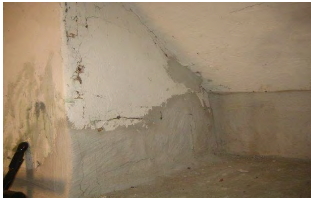
Defekt puds mod trapperum i kælder
