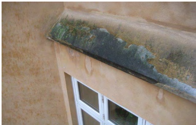
Skrå sålbænk ved bygningspring (tidligere faldet ned)
