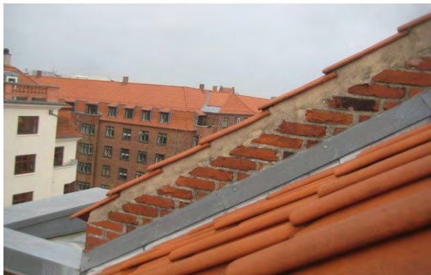
Brandkam i blankt murværk. Små svindrevner i forskelling
