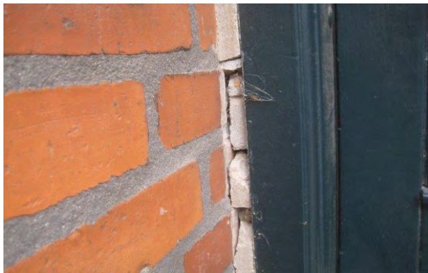
Defekt mørtelfuge ved døre i gadefacade
