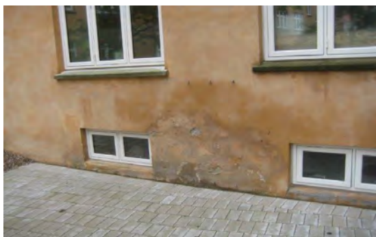
Fugtskadet facade i stueplan
