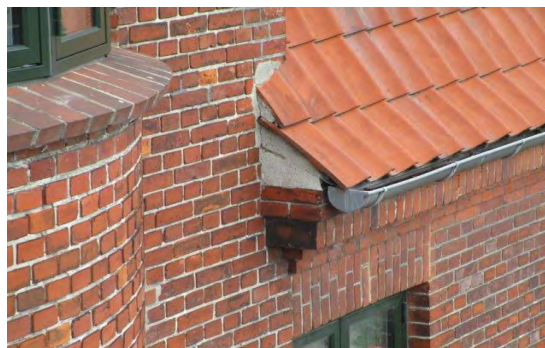
Stor mørtelpude med begyndende nedbrydning
