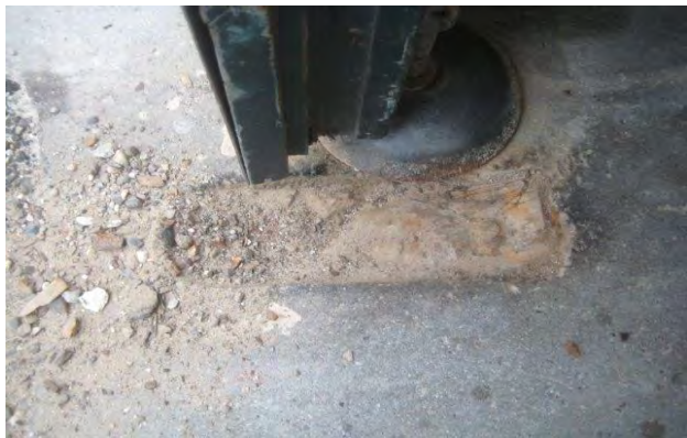
Skade på belægning ved skudrigle
