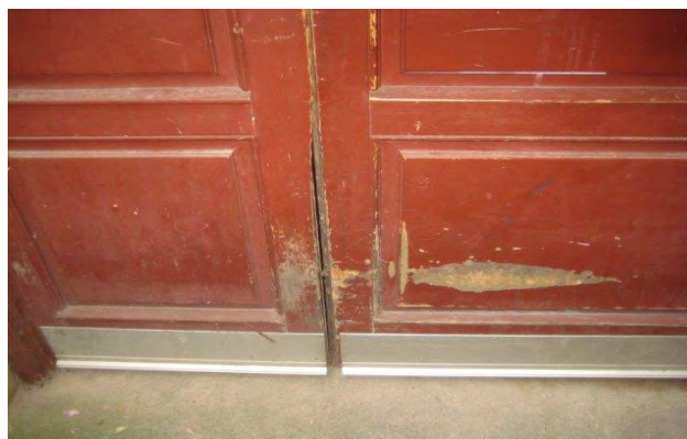
Utæt og nedslidt dør til kælder ved LG 9
