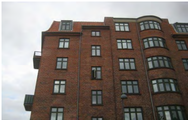
Område med udvaskede fuger ved Artillerivej
