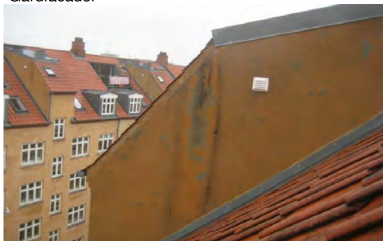
Udvasket puds på trappetårn under "kort" inddækning
