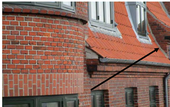
Manglende inddækninger mod trappetårn gadefacade
