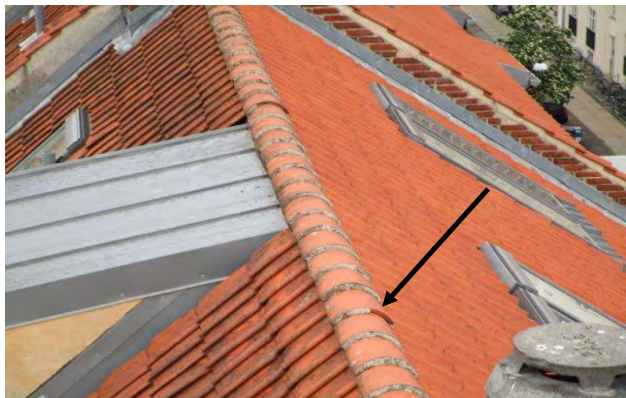
Manglende mørtel ved rygningsten
