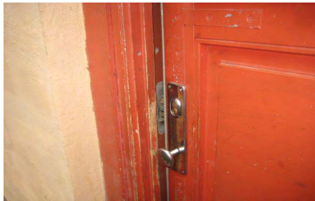
Nedslidt malerbehandling på kælderdør
