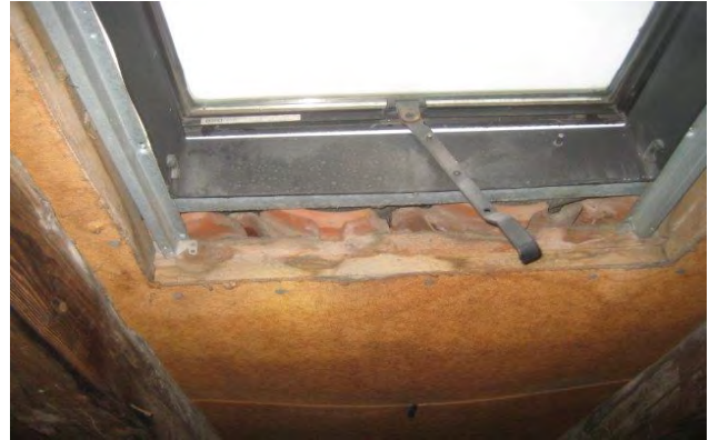
Manglende undertagskrave ved ovenlys
