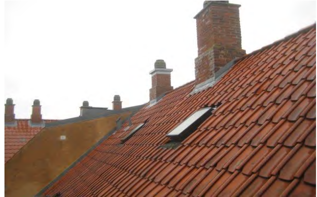
Skorsten med udvaskede fuger
