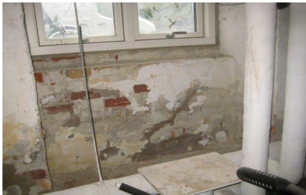
Afskallet puds og fugtskade på kældervæg
