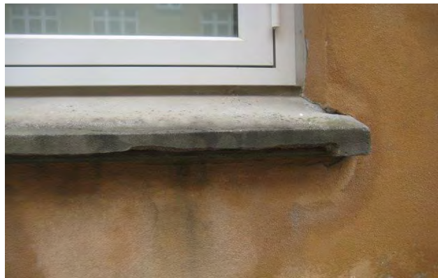
Defekt sålbænk i gård
