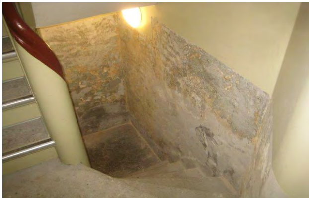
Filt fjernet ved fugtskadede vægge på bagtrapper
