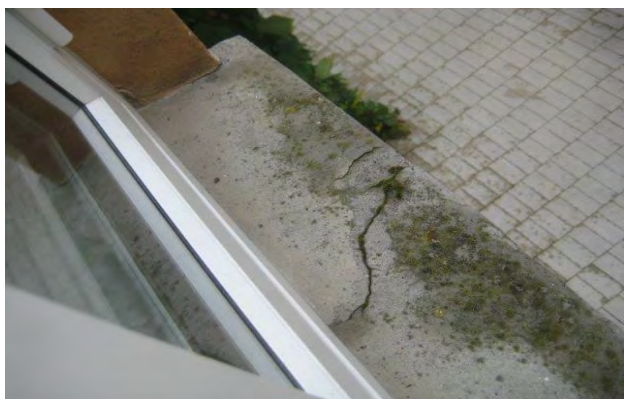
Nedbrudt og revnet sålbænk i gård
